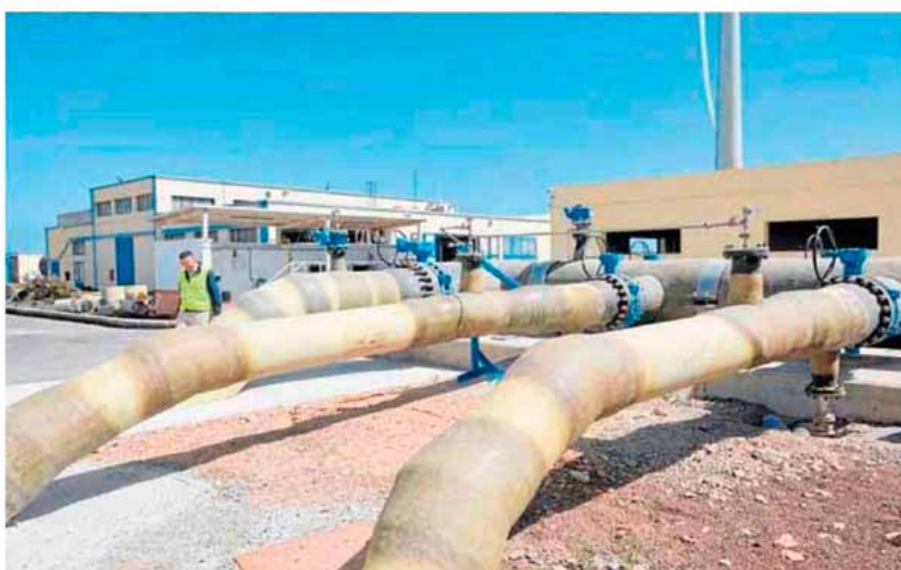
Tuberías que enlazan la desaladora del CAAF en Puerto del Rosario con los depósitos de La Herradura. J.M. / ACPI
